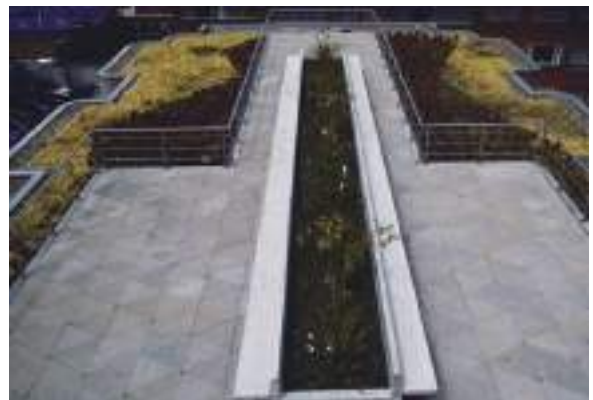
Parte de la cobertura del edificio de la Secretaría Distrital de Ambiente de Bogotá disponible en OAB Crédito: Observatorio Ambiental de Bogotá
